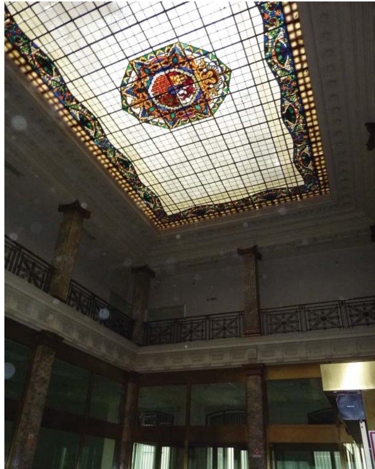
Restauración de la vidriera y recuperación del patio de operaciones como espacio central.
