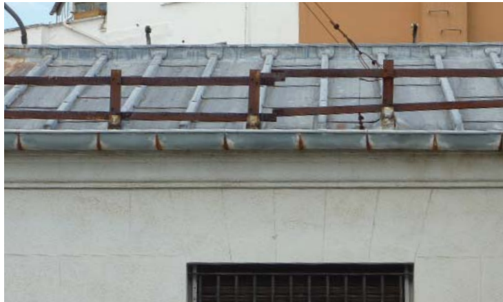
Nuevo sistema de evacuación de pluviales.
